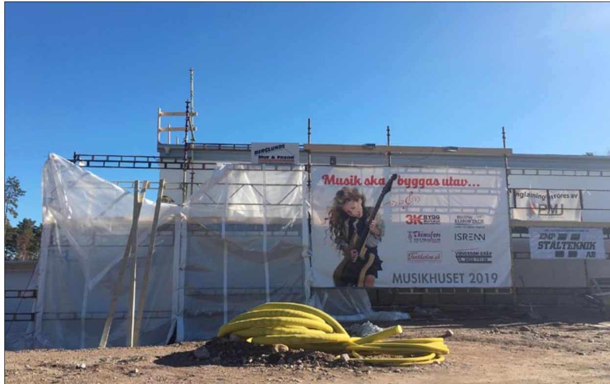
Musikhuset, som än så länge är en byggarbetsplats, är på gång och första musikevenemanget hålls i slutet av augusti.
